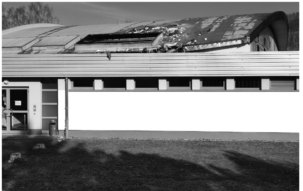
Am Tag danach. Der Brandherd hatte sich durch das Dach gefressen.
