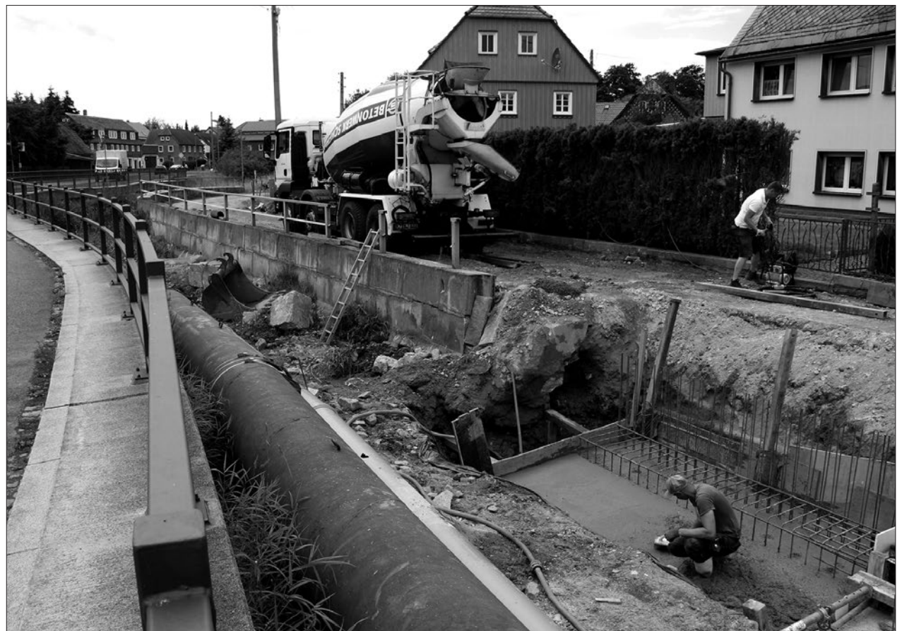
Die Bauarbeiten am Erlenweg gehen Schritt für Schritt voran. Dem Abriss alter Stützmauerteile folgen Fundamentarbeiten für das neue Bauwerk.
