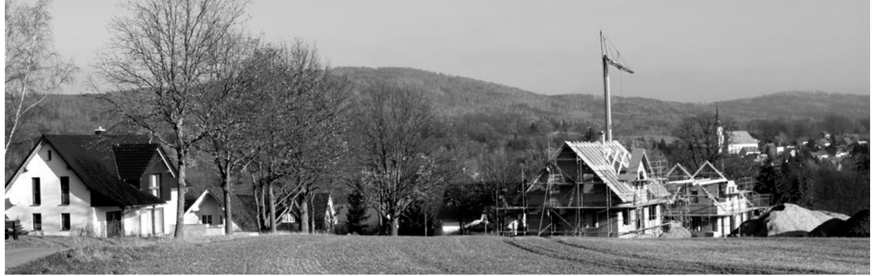
Blick auf die Baustellen am „Heiteren Blick“ auf dem Weigsdorfer Berg. Die Gemeinde hatte hier erst 2020 Baurecht geschaffen.
