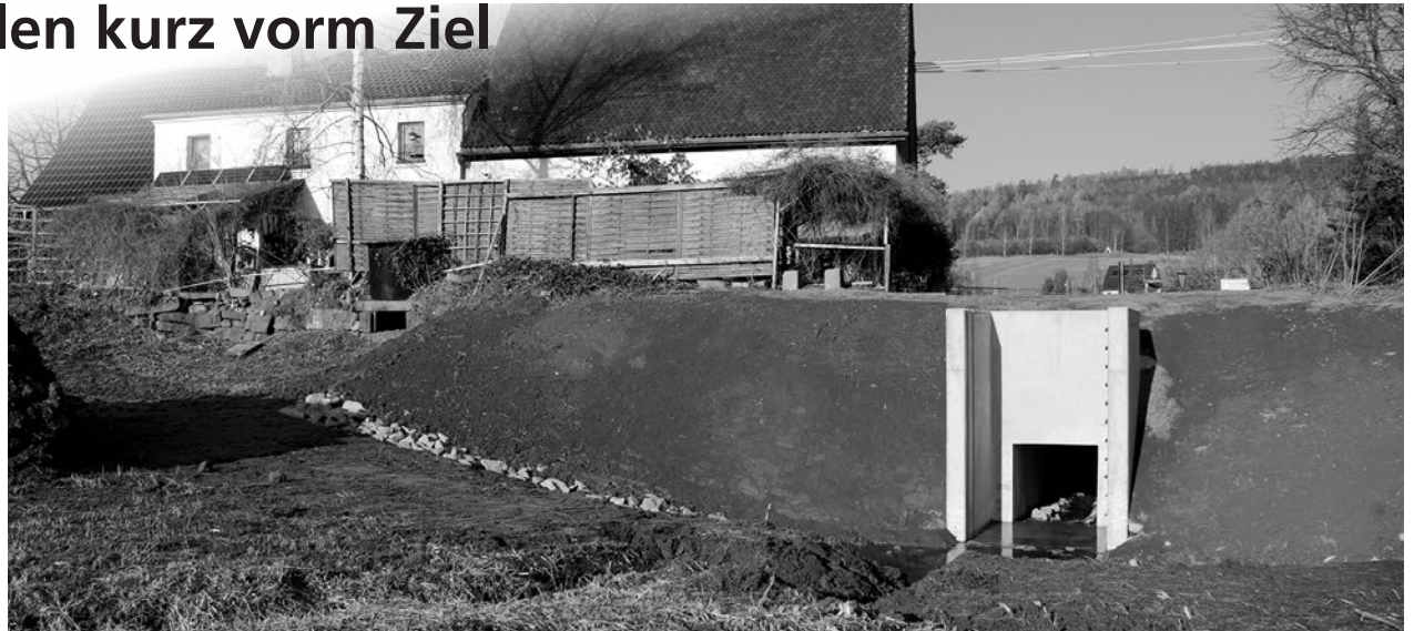
Der alte Mönch ist abgebaut, beim neuen Bauwerk werden nun schrittweise die Schieber eingesetzt und der Teich wieder langsam angestaut.
