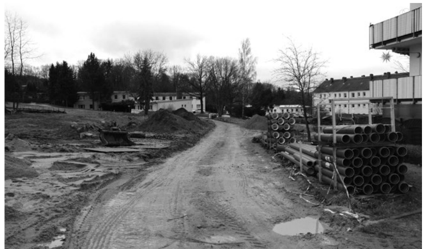
Die Arbeiten an verschiedenen Medienleitungen sind in der Friedensau noch nicht abgeschlossen.
