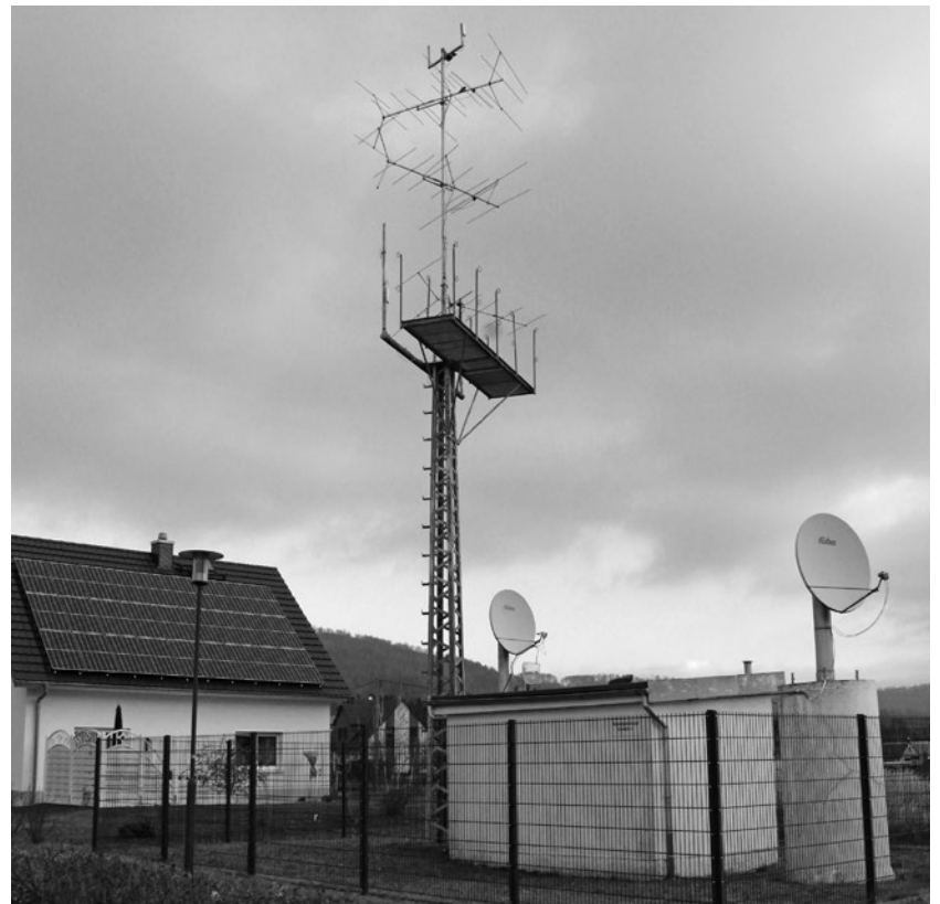
Die Empfangs- und Verteilerzentrale der Antennengemeinschaft Cunewalder Tal steht seit über 30 Jahren am Siedlungsweg.
