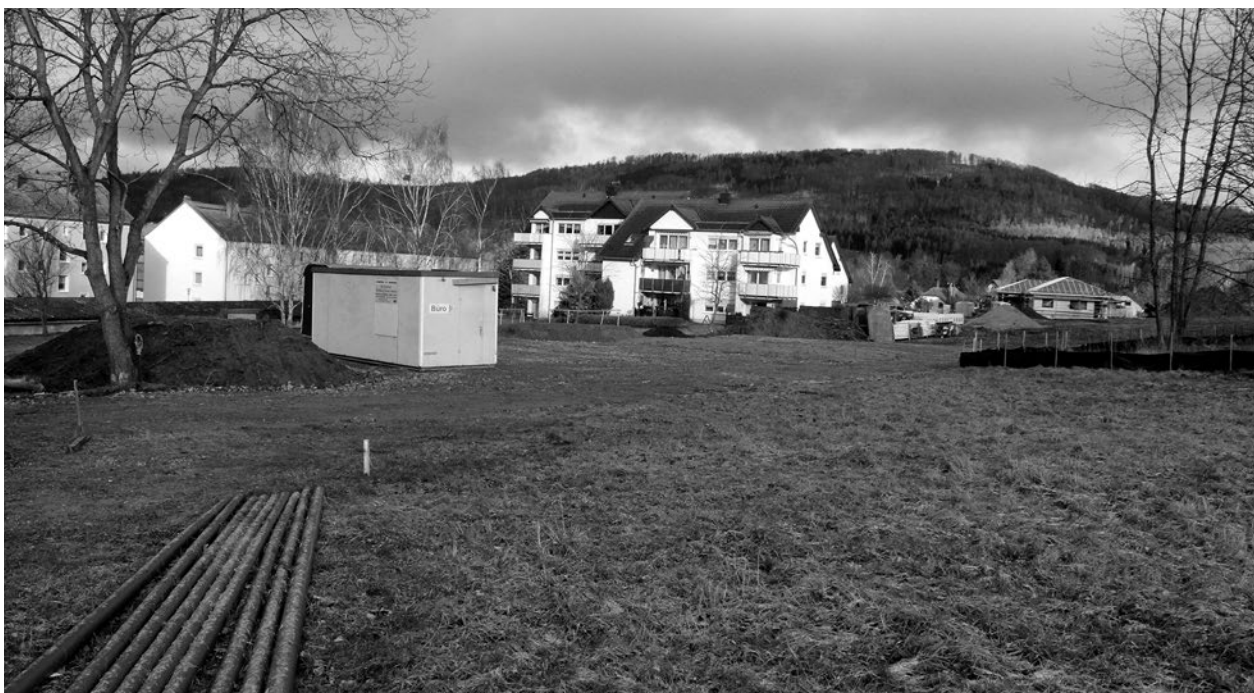
Links im Vordergrund liegen die Rohre für die Trinkwasserversorgung bereit. Hinten rechts ist bereits das erste neue Wohnhaus am Standort Friedensauwe erkennbar.
