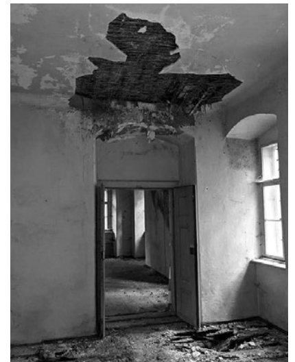
Im 1. Obergeschoss zeigen sich massive Schäden, verursacht durch offene Stellen im Dach.
